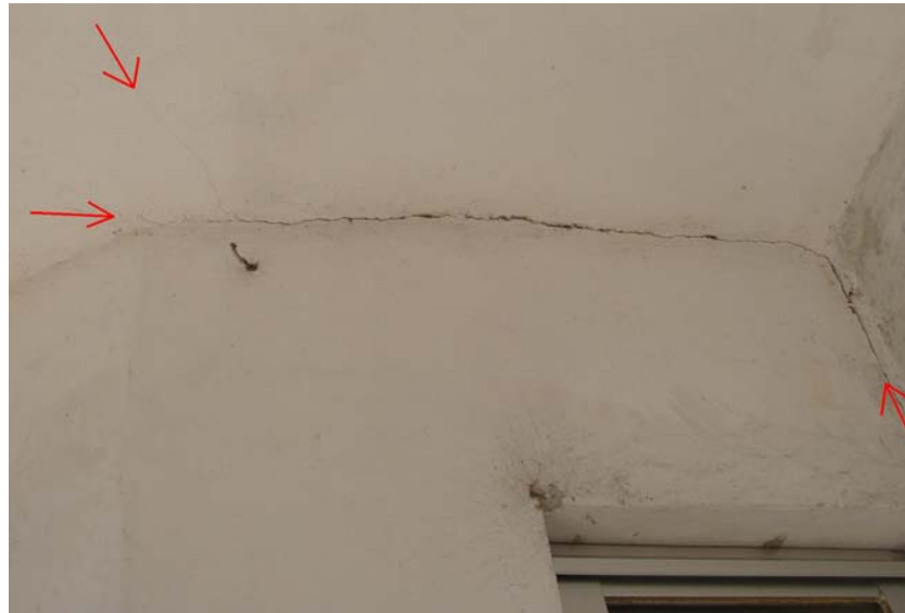
Figura 40 - Avaria acima da janela menor do quarto maior. As setas apontam para extremidades das rachaduras na laje de teto e nas interfaces entre paredes e laje. A rachadura na laje se prolonga pelo teto do quarto maior.
