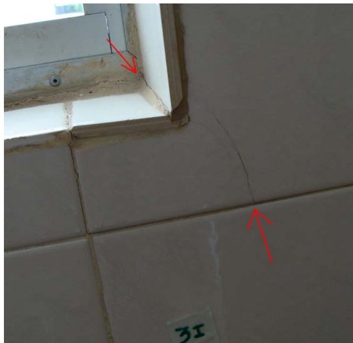
Figura 22 - Avaria 3, na face interna de uma das paredes do BWC anexo à sala, em continuidade à rachadura observada na face externa. As setas apontam para extremidades da rachadura na face interna. No mesmo BWC há uma rachadura no teto.
