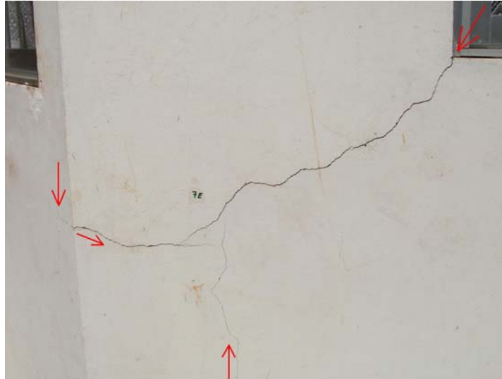
Figura 29 - Avaria 7, na face externa de uma das paredes da cozinha, partindo do vértice inferior esquerdo da janela frontal. As setas apontam para extremidades das rachaduras, visíveis também na face interna, mostrando que se trata de ruptura da parede de alvenaria, devido a recalques de sua fundação, conseqüentes de deslocamentos do solo.
