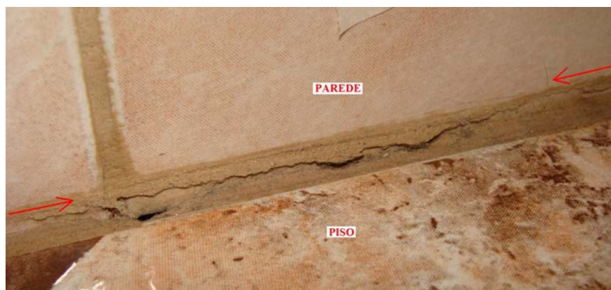
Figura 33 - Detalhe da figura anterior (avaria 9), no piso da cozinha, na aresta com a parede adjacente à obra.
