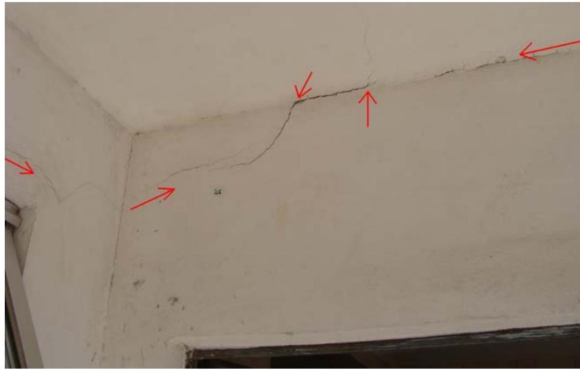
Figura 23 - Avaria 4, na face externa de uma das paredes da cozinha e na laje de teto, acima da porta para o exterior. As setas apontam para extremidades das rachaduras, visíveis também na face interna, mostrando que se trata de ruptura da parede de alvenaria, devido a recalques de sua fundação, conseqüentes de deslocamentos do solo.
