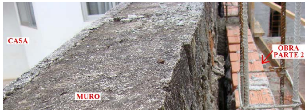
Figura 11 - Tomada fotográfica a partir do topo do muro lateral direito da casa examinada, na qual se pode observar: à esquerda, vista parcial da casa examinada; no centro, o topo do muro de divisa lateral; à direita, a parede posterior da parte 2 da obra e armaduras de pilares.
