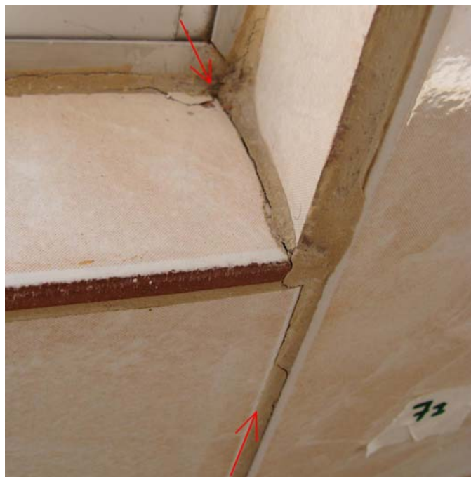
Figura 30 - Avaria 7, na face interna da parede frontal da cozinha, em continuidade às rachaduras na face externa. As setas apontam para extremidades das rachaduras.
