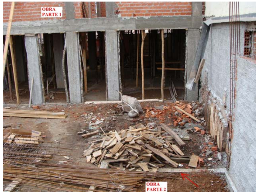
Figura 13 - Tomada fotográfica a partir do topo do muro lateral direito da casa examinada, na qual se pode observar: ao fundo, uma vista parcial da parte 1 da obra (dois pavimentos); em primeiro plano, a parte 2 da obra (a seta vermelha indica uma das vigas de baldrame que serve de fundação para paredes da parte 2 da obra, a serem levantadas).
