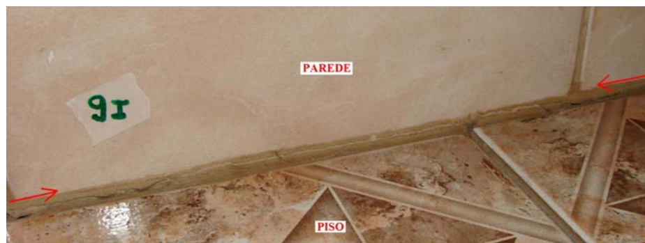
Figura 32 - Avaria 9, no piso da cozinha, na aresta com a parede adjacente à obra. O piso sofreu afundamento, surgindo a rachadura (indicada pelas setas) na aresta com a parede. O afundamento ocorreu devido a deslocamentos do solo sobre o qual o piso se apóia.
