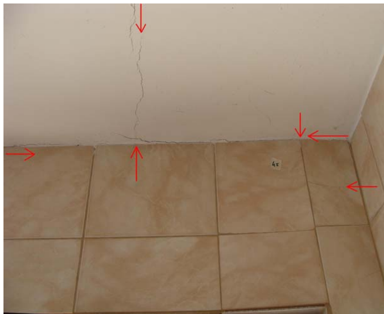
Figura 24 - Avaria 4, na face interna de uma das paredes da cozinha e na laje de teto, acima da porta para o exterior. As setas apontam para extremidades das rachaduras, em continuidade às rachaduras na face externa da parede.
