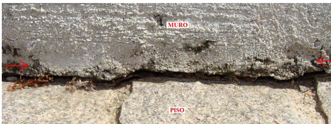
Figura 42 - Avaria no piso externo, junto ao muro lateral direito (para quem olha da rua). A figura é um detalhe da avaria mostrada na figura 04, lá indicada pelas setas azuis horizontais. O piso sofreu afundamento devido ao deslocamento do solo sobre o qual se apóia. As setas apontam a direção do espaço que surgiu entre o piso e o muro. Não foram observados sinais de recalques junto ao muro lateral esquerdo.
