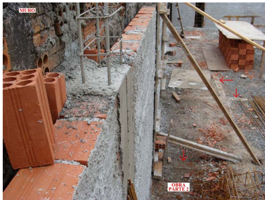
Figura 12 - Tomada fotográfica a partir do topo do muro lateral direito da casa examinada, na qual se pode observar: à esquerda, o muro de divisa lateral; no centro, a parede posterior da parte 2 da obra (face chapiscada, pilares parcialmente concretados, esperas de armaduras de pilares expostas); à direita (setas vermelhas ), algumas vigas de baldrame que servem de fundação para paredes da parte 2 da obra, a serem levantadas.
