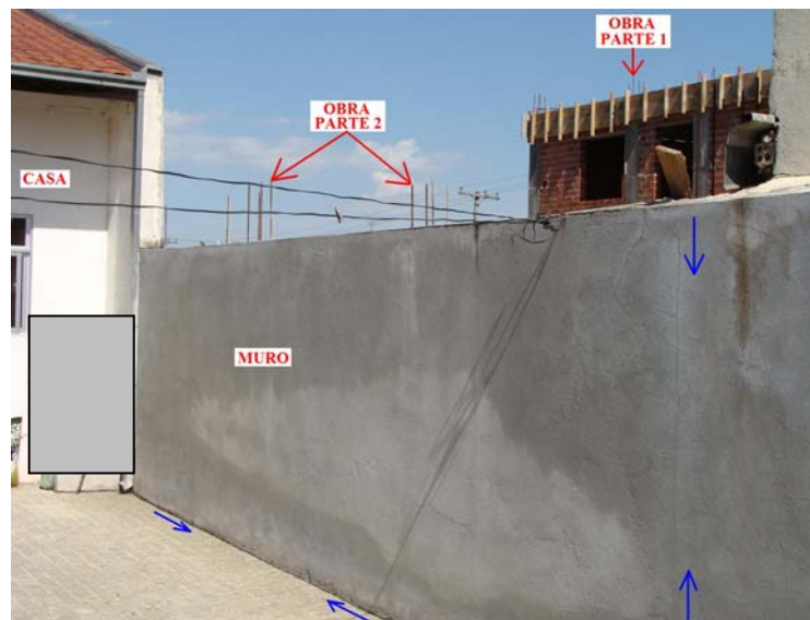
Figura 04 - Tomada fotográfica em que se pode observar: casa examinada (à esquerda), muro lateral direito que confronta com a parte 2 da obra de construção em execução e vista parcial da parte 1 da obra. As setas azuis verticais indicam uma rachadura vertical no muro lateral. As setas azuis horizontais indicam um recalque (rebaixamento) do piso externo à casa, ao longo do muro lateral.
