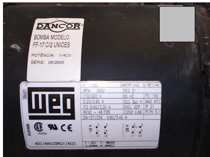
Figura n.º 12 – Etiquetas de identificação de uma das quatro motobombas da marca Dancor, modelo PF-17, com motores elétricos da marca Weg com potência de 1/4 CV
