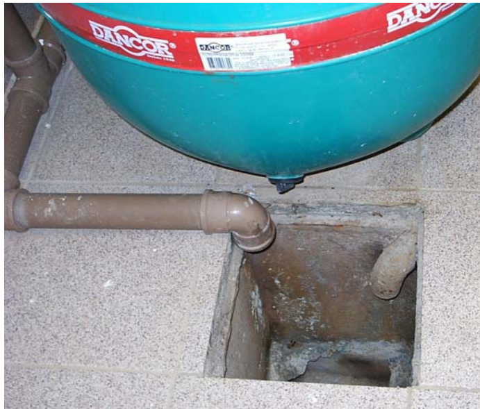
Figura n.º 17 – Ralo não-sifonado e sem grelha superior, no qual descarregam os drenos dos equipamentos.
