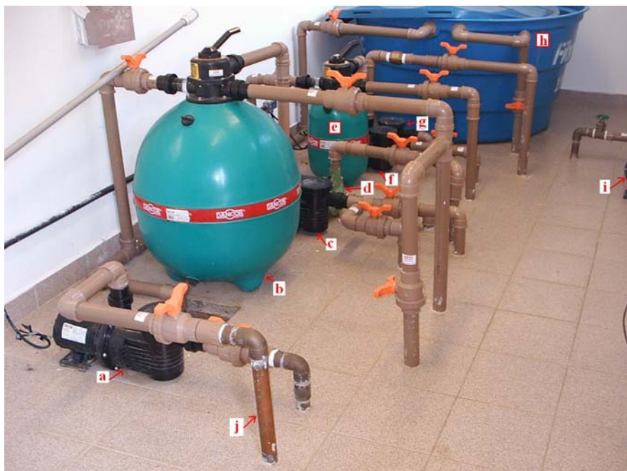
Figura n.º 09 – Tomada fotográfica geral da casa de máquinas: a) motobomba de 1/4 CV (bomba de calor); b) filtro da piscina; c) motobomba de 1,5 CV; d) motobomba de 1,5 CV da “cascata”; e) filtro da banheira; f) e g) motobombas de 1/4 CV; h) cisterna de 1000 litros; i) motobomba do aquecedor de passagem; j) tubulação da bomba de calor sem isolamento térmico
