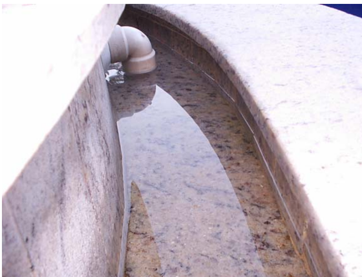
Figura n.º 06 – Tomada fotográfica do reservatório da “cascata” (desligada)
