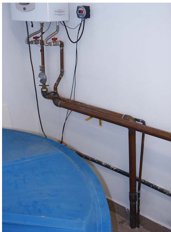
Figura n.º 10 – Tubulação de cobre para água quente do aquecedor de passagem a gás, sem isolamento térmico
