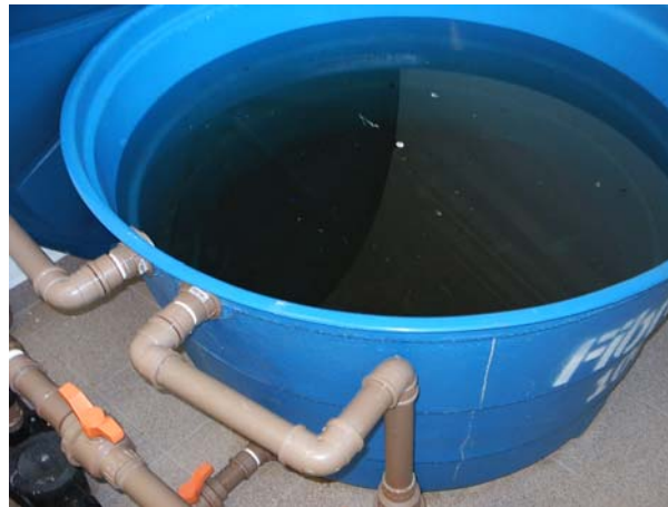
Figura n.º 11 – Cisterna sem dispositivo automático de máx. e mín. especificado no projeto hidro-sanitário
